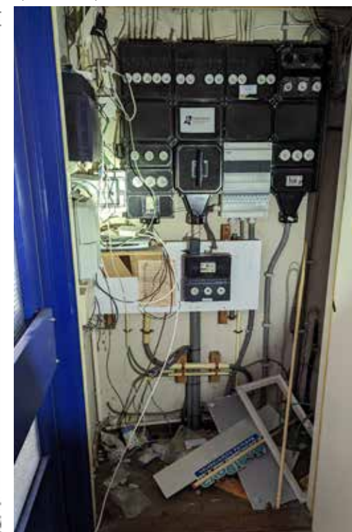
Afbeelding 2.1.9 - Meterkast elektra aansluiting in de hal
